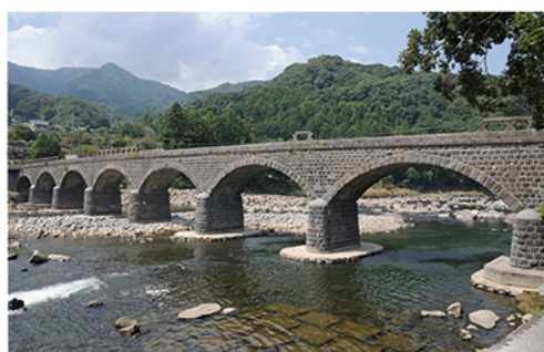
高欄の半分以上が流失した耶馬溪橋 写真提供/中村まさあき
